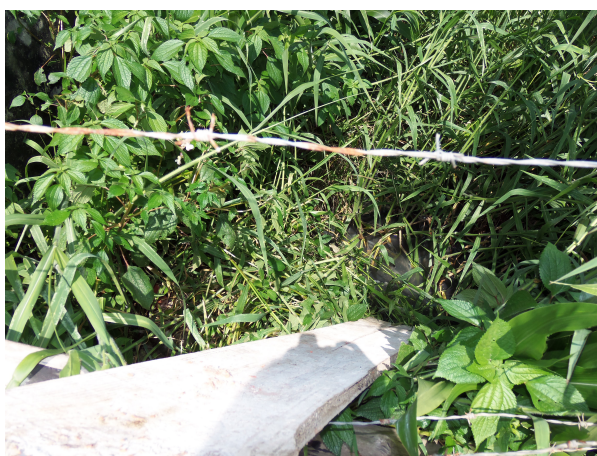
Situação de terreno na Rua da Vila Barreira onde a vala só pode ser vista abrindo caminho entre o mato Abaixo a tubulação é prejudica
