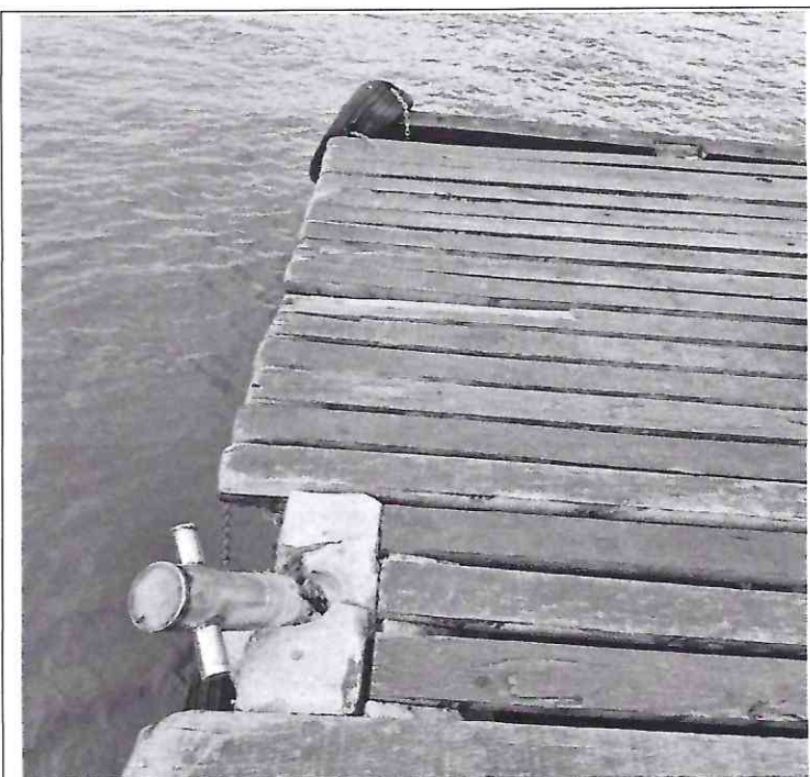
Imagem 01: Sistema de amarração com cabeço metálico (bollard) danificado.
