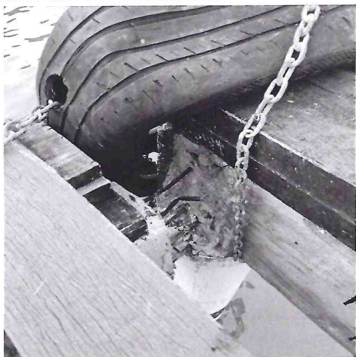
Imagem 03: Ruptura do bloco de apoio de concreto.
