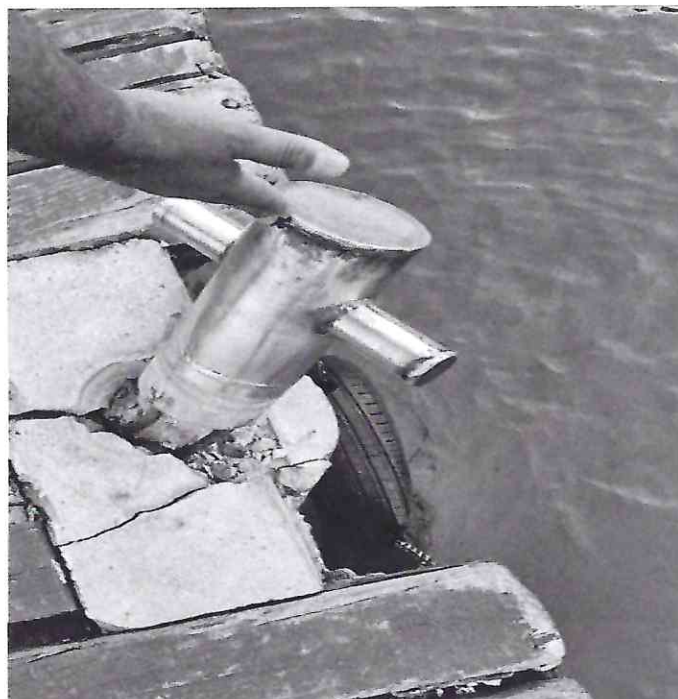
Imagem 04: Perda de aderência/resistência entre o cabeço metálico e a base.
